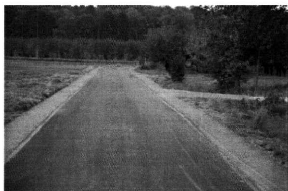
Przebudowa drogi nr ewid. dz. 121 w miejscowości Mokre, od km 0+000 do km 0+450.
